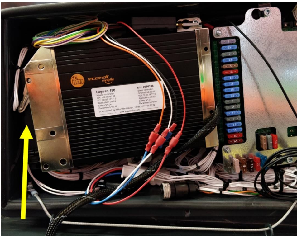
Bilde 32. Kontakter til Logic-kontrollerne (2 stk.)
